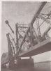
Detalhe do pórtico e tramo fronizante da ponte, com o abutro de concreto e o concreto sob o abutro de fato.
